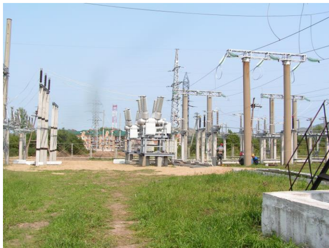
Змеиногорская подстанция. (Фото из архива ЮЭС).
